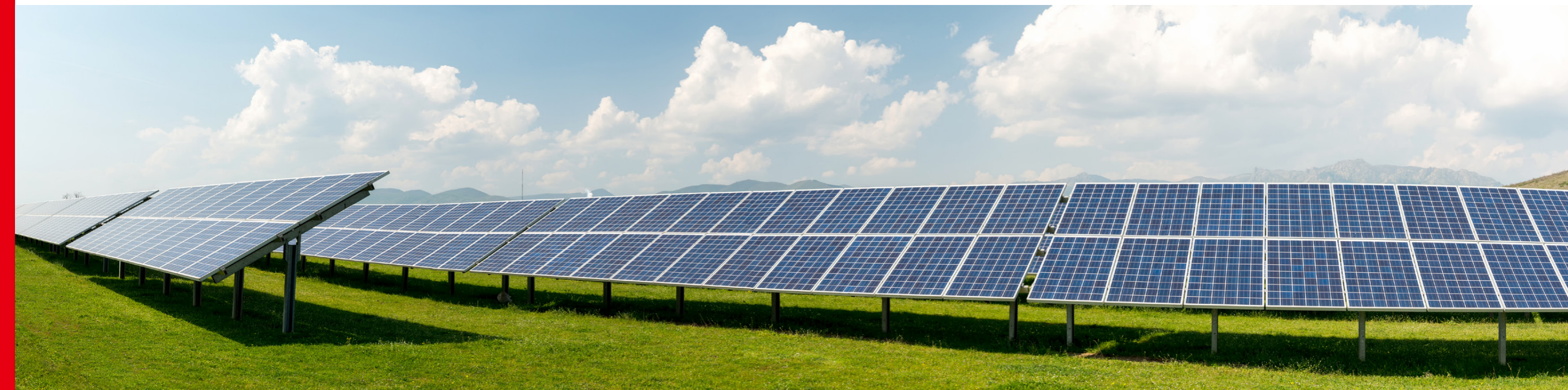
七项核心技术能力赋能零碳智慧园区建设
